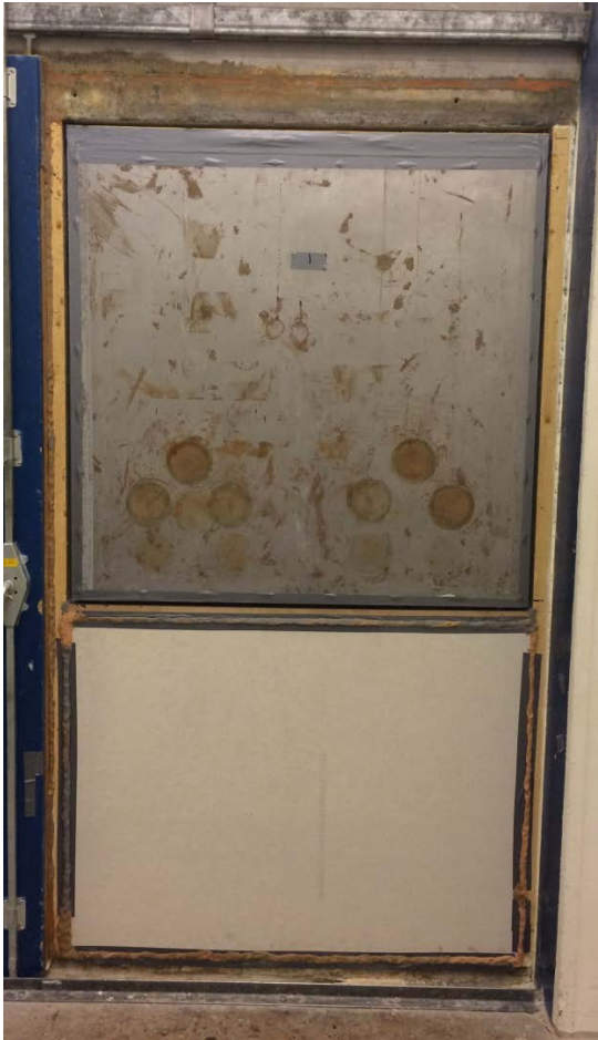
Bild 1 – Mottagarrummet (utsida), drevsystem 1. Tom fog.
